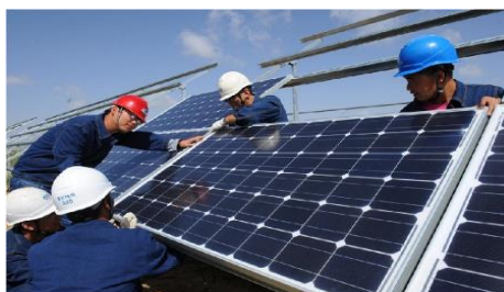
上图：光伏发电系统
